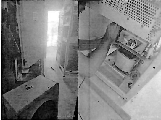
Se retira motor de enfriamiento y la tapa delantera del transmisor para tener acceso a la fuente de poder para revisarla.
