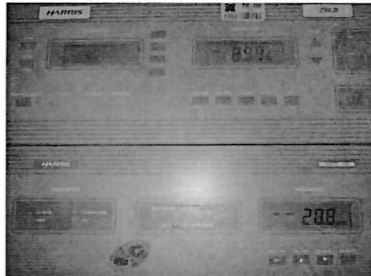
Se pone en operación el transmisor de FM y se configura para potencia media, se deja trabajando
